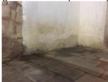
Figura 3 – Umidade por infiltração
