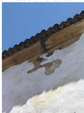
Figura 4 – Descolamento do revestimento
