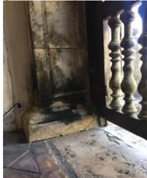
Figura 2 – Sujidade em pilar
