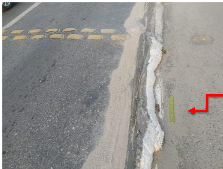
Figura 5 – Patologia do tipo Escorregamento localizada acerca de 100 metros a partir do ponto inicial da via, área objeto de estudo. Fonte: Próprio Autores, 2020.
