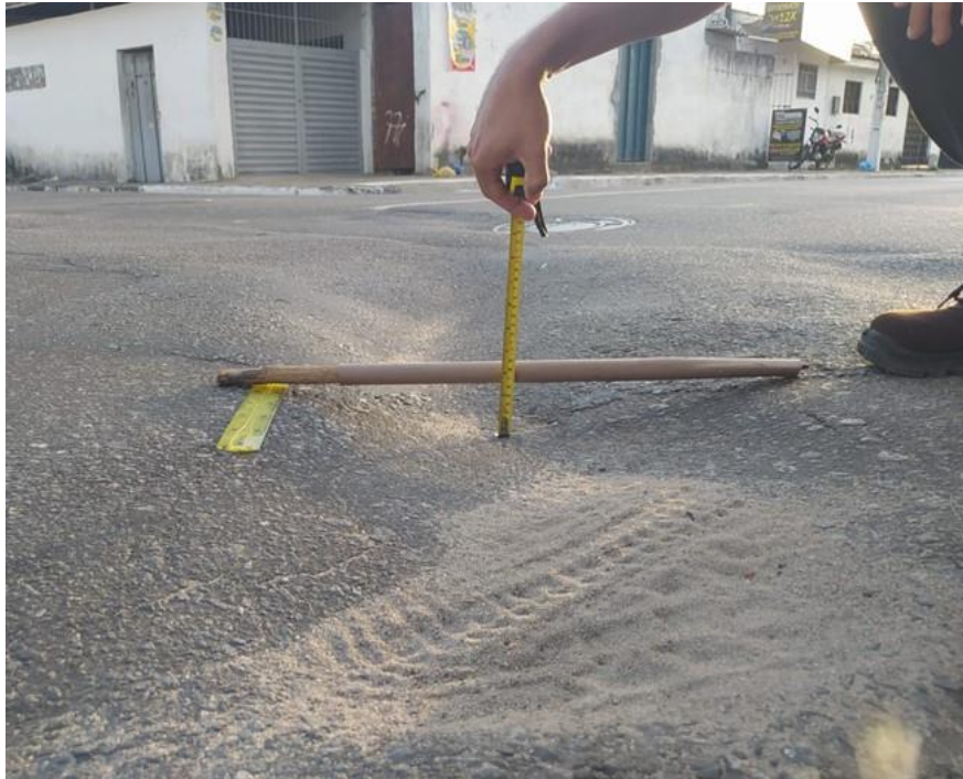
Figura 4 – Patologia do tipo afundamento plástico pontual, com 5cm de profundidade por 40 cm de largura em média e com dimensões aproximada de 950 metros, encontrada no trecho inicial da rodovia, Avenida Brasil, município de Bayeux-PB.
