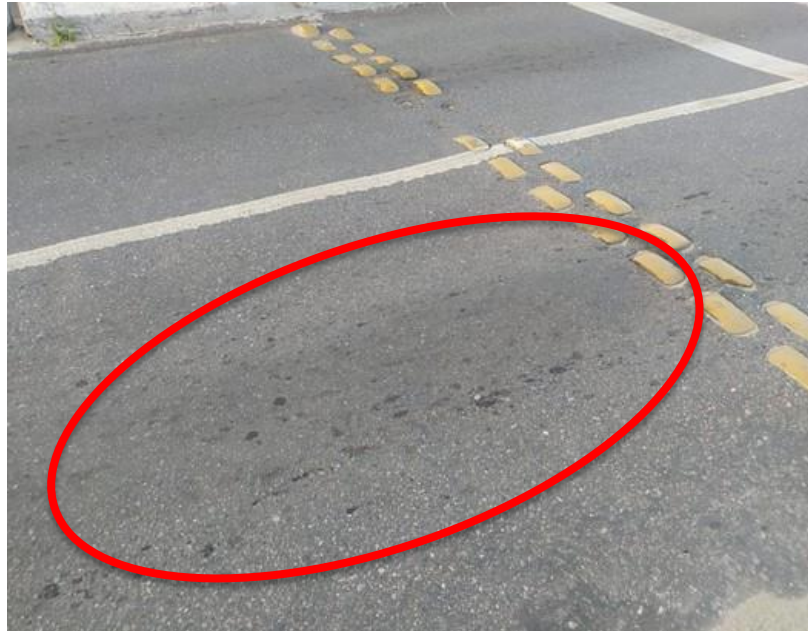
Figura 5 – Patologia do tipo desgaste localizada a 1.500 metros desde o trecho inicial da rodovia Avenida Brasil, município de Bayeux-PB. Fonte: Próprio Autores, 2020.
