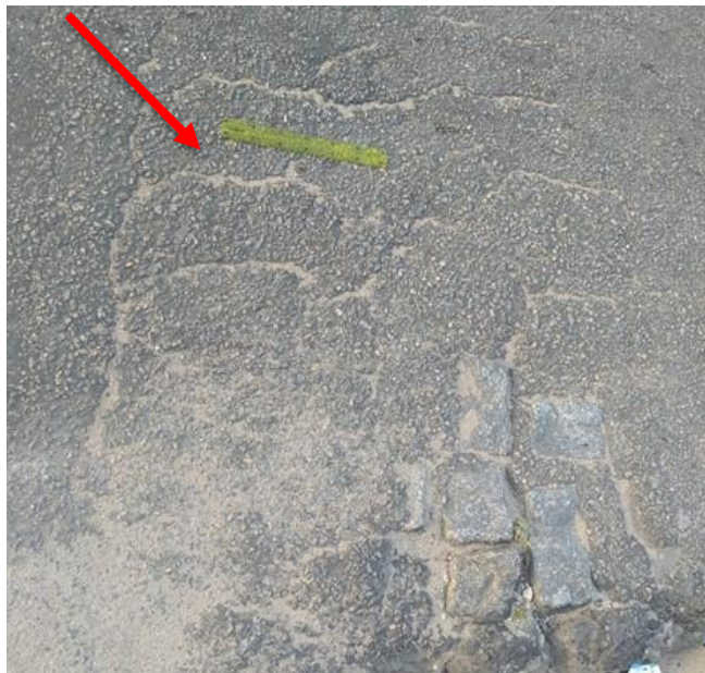
Figura 5 – Patologia do tipo Fissura/Trinca com a presença de patologia do tipo pelada encontrada numa distância aproximada de 1.850 metros a partir do ponto inicial da rodovia área objeto de trabalho.
