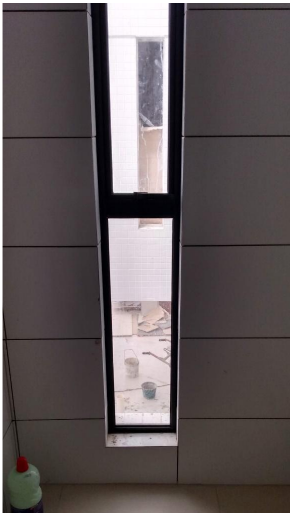
Figura 30 - Janela do banheiro da Torre B, sem películas de privacidade.
