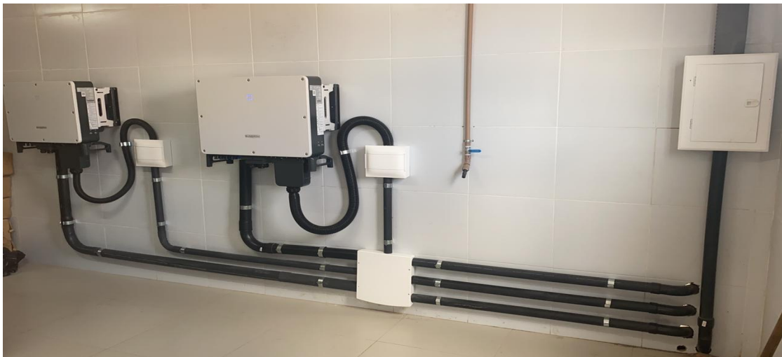
Figura 5: Arranjo dos cabos c.a conectando-se a duas string box e inversores.
