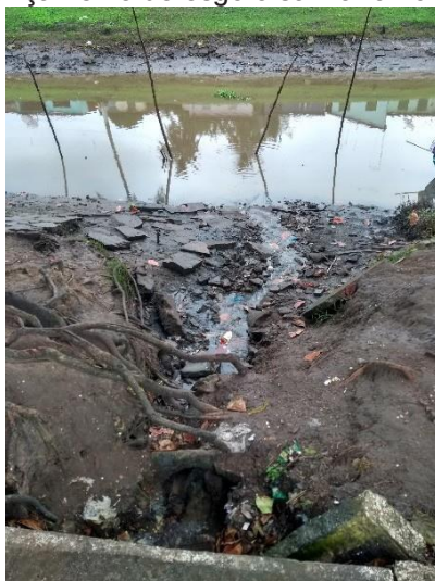
Figura 01: Lançamento de esgoto sanitário no canal goiana.
