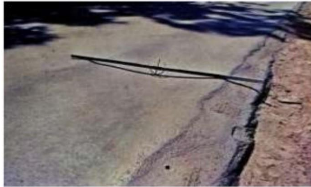
Figura 7 - Afundamento por trilha de roda.
