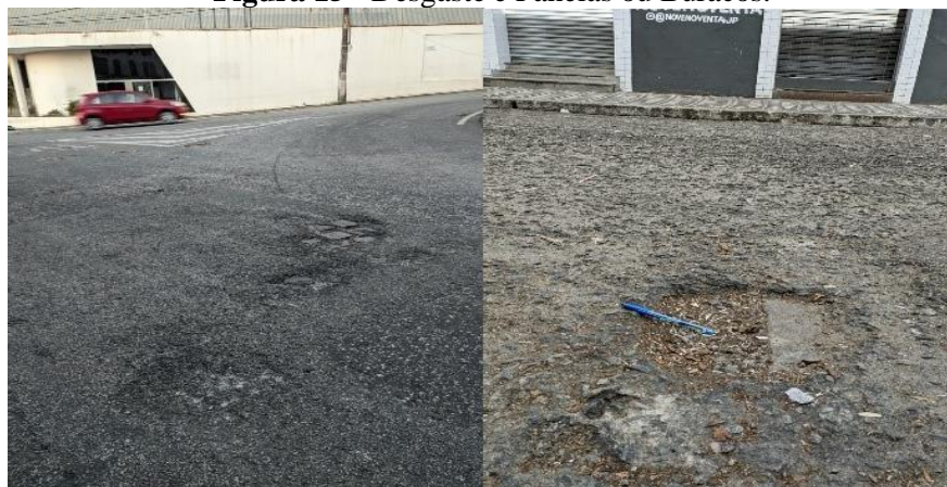
Figura 15 - Desgaste e Panelas ou Buracos.
