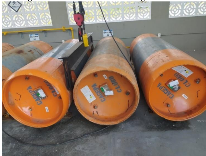
Figura 12 – Reservatórios de cloro gasoso
