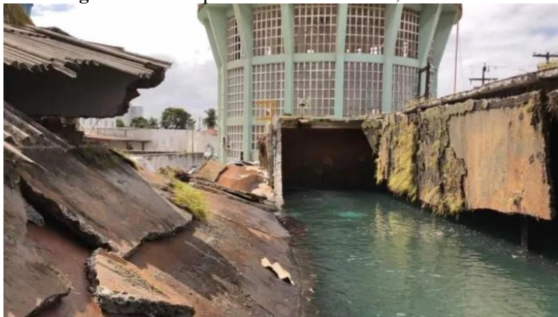
Figura 16 – Rompimento do reservatório, BR1
