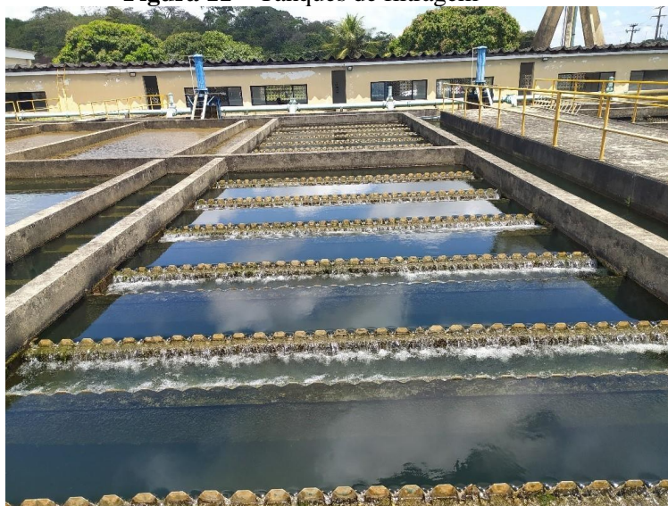
Figura 11 – Tanques de filtragem
