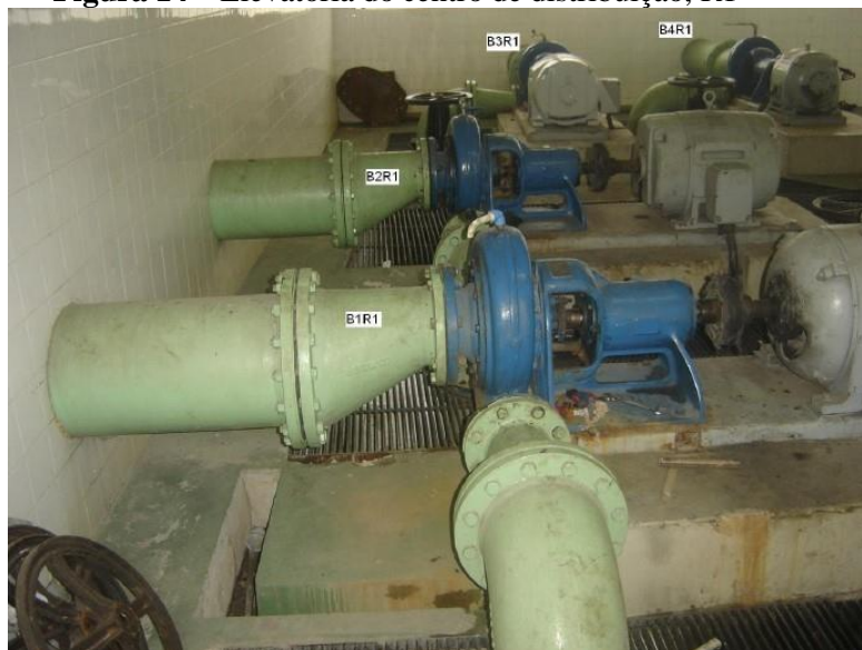
Figura 14 – Elevatória do centro de distribuição, R1
