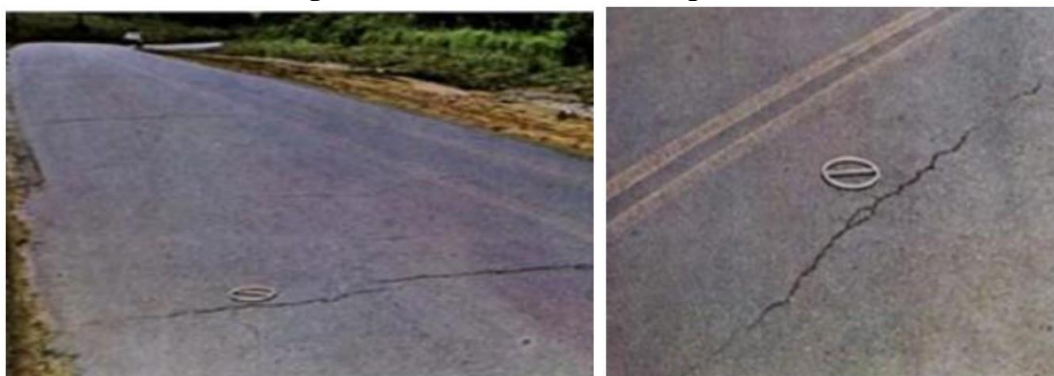
Figura 6 - Trinca transversal e longitudinal.
