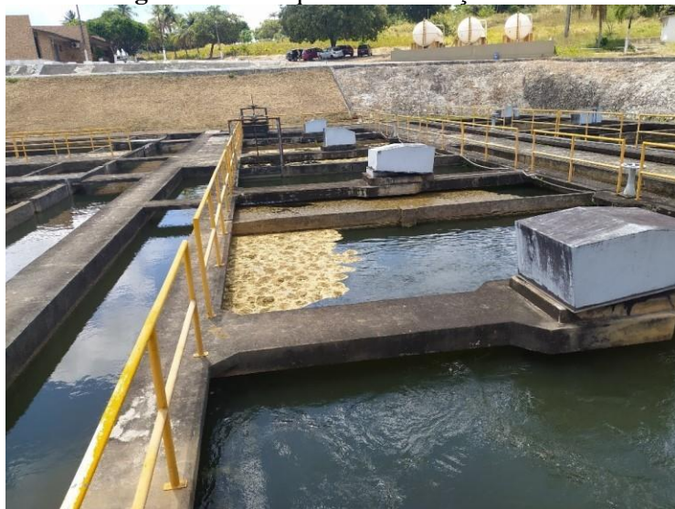
Figura 10 – Tanques de decantação
