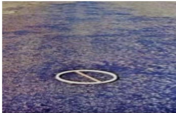
Figura 8 - Exsudação causado por excessiva quantidade de ligante.
