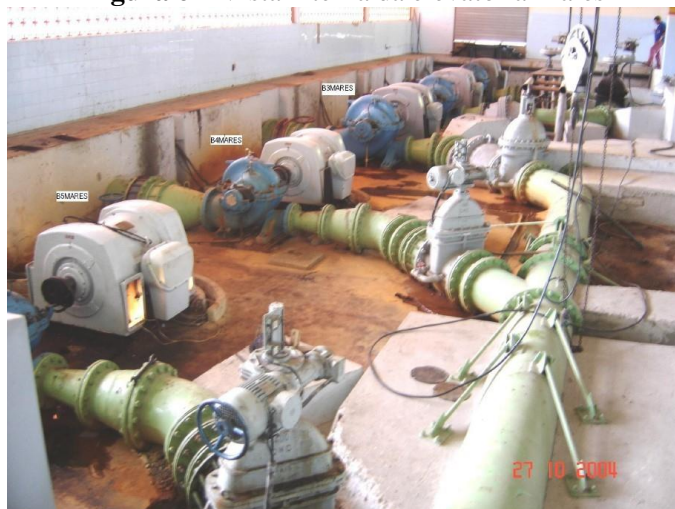
Figura 6 – Vista interna da elevatória Marés
