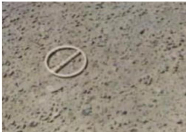
Figura 9 - Desgaste provocado por esforços tangenciais causados pelo tráfego.
